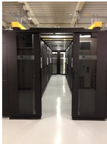
Un couloir de baies de serveurs
